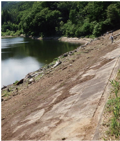
復旧が必要な堤体
