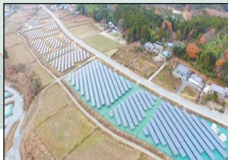
大熊町ふるさと再興メガソーラー発電所 (約1.9MW)
