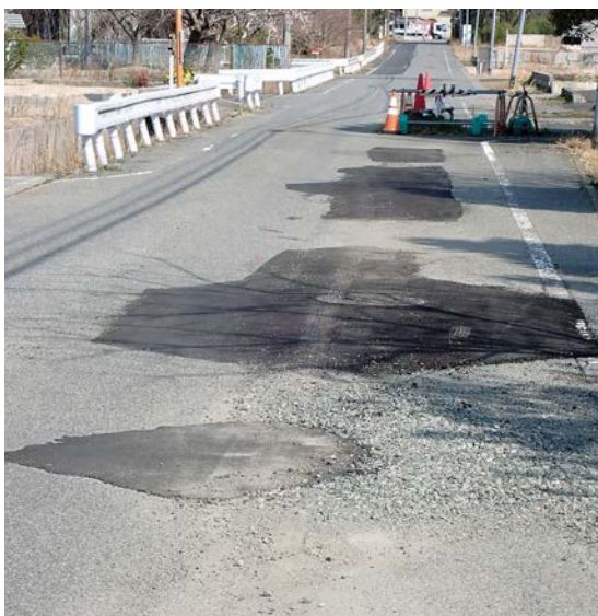
仮復旧の状態では好ましくない
