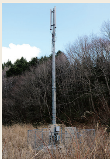
万右工門地区にある携帯電話基地局
