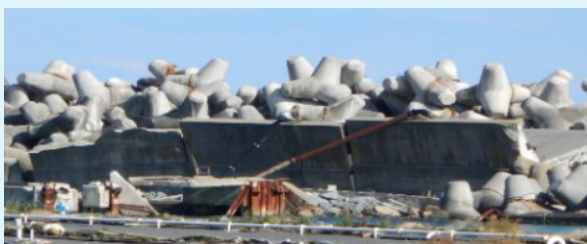
壊れた防波堤の上に設置されている仮設の防波堤
