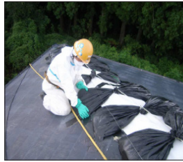
＜屋根養生工事の様子＞ 不具合のある部分をシートで覆い、その上に飛散防止の土のうを配置します。
