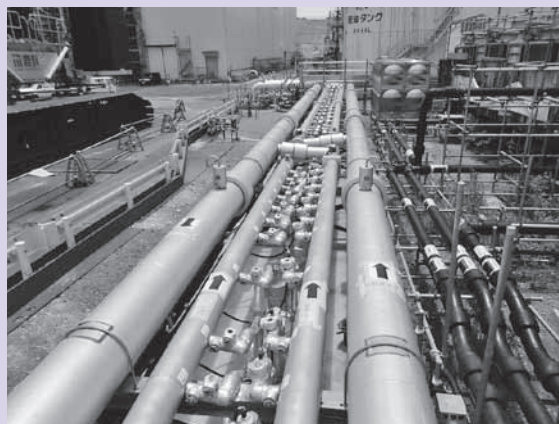
凍土壁の冷却材配管
