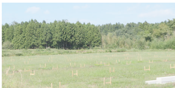
▲設置位置に木杭が打ち込まれていました。一面がソーラーパネルになると想像すると圧巻です
