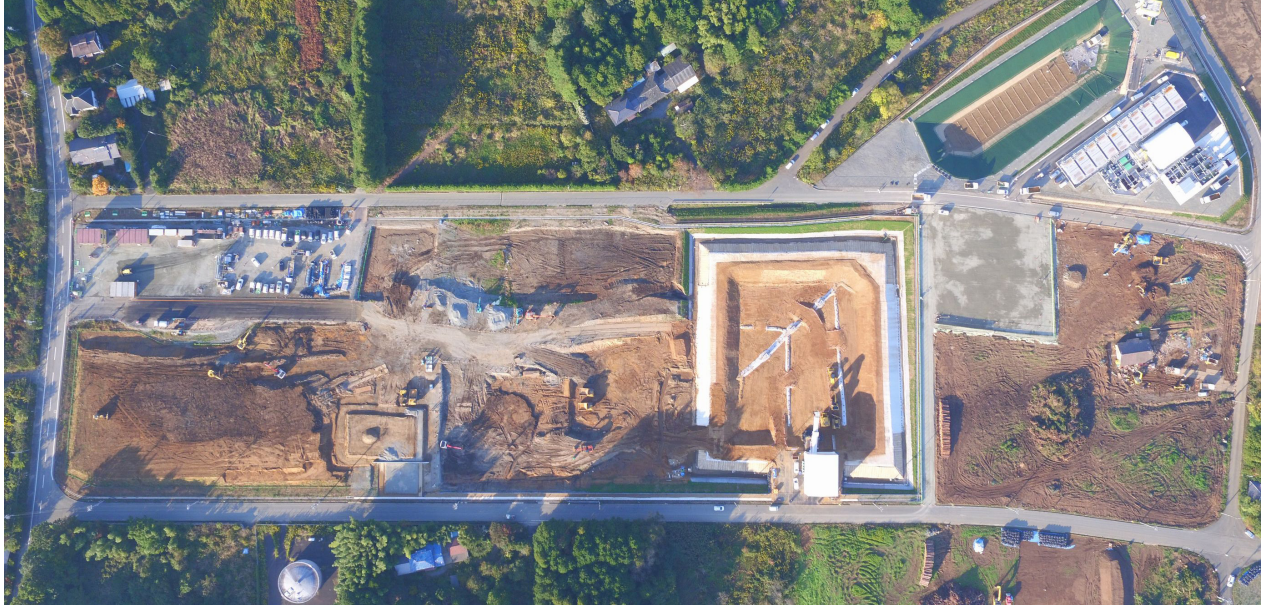
稼働した町内の土壌貯蔵施設（清水・竹中土木・東洋 特定建設工事共同企業体提供）
