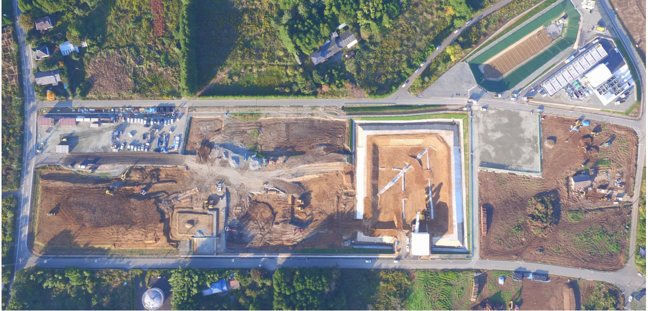
稼働した町内の土壌貯蔵施設（清水・竹中土木・東洋 特定建設工事共同企業体提供）
