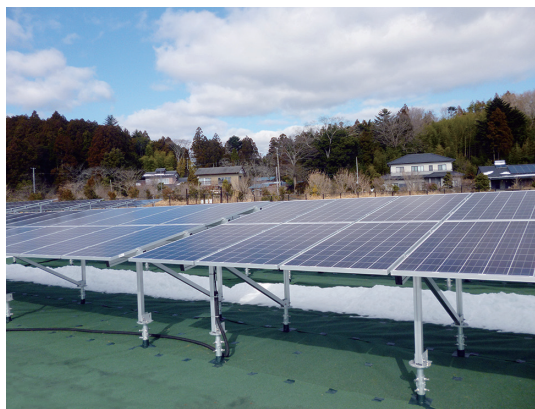
大川原地区で稼働した太陽光発電
