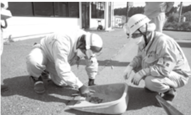
▲線量の高いアスファルトの継ぎ目
