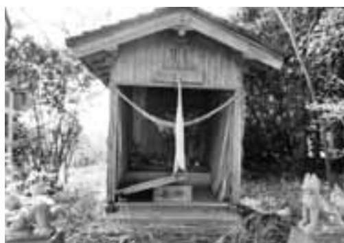
正一位稻荷神社(熊川) 扉部分が壊れている。内部が野ざらし状態。 半壊
