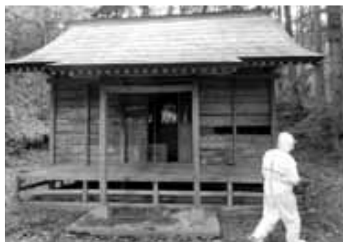
東堂山(夫沢) 本殿が倒壊。拝殿は健在。 半壊
