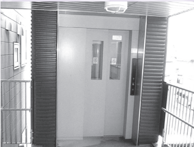
エレベーター
